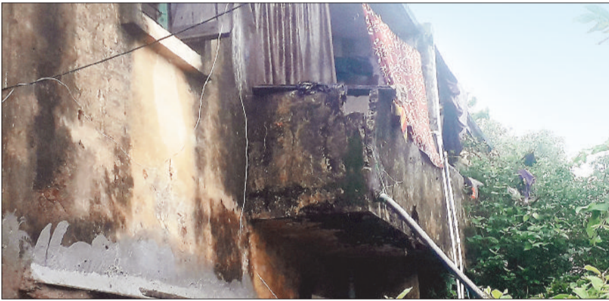
पुलिस लाइन स्थित जर्जर पुलिस क्वार्टर।
